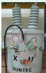
Figura 4 Conexión en el transformador del cable de alimentación del equipo de control.
