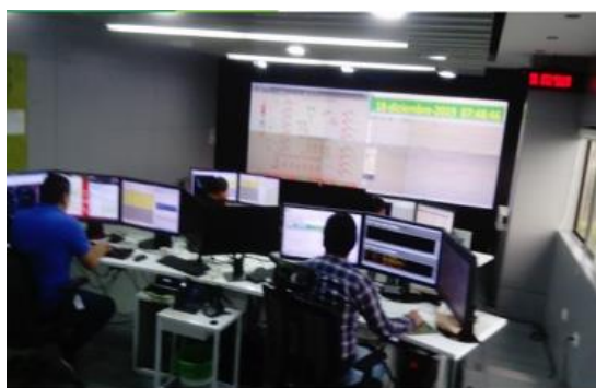
Fotografía 4. Centro de Control CENS
