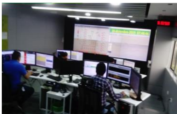
Fotografía 2. Centro de Control CENS
