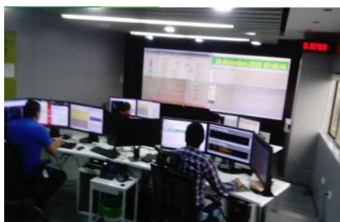
Figura 22. Centro de Control CENS
