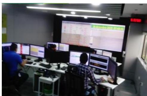
Figura 22. Centro de Control CENS
