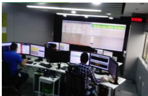
Figura 22. Centro de Control CENS
