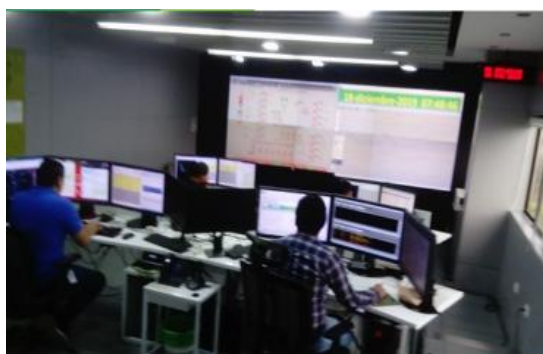
Figura 21. Centro de Control CENS
