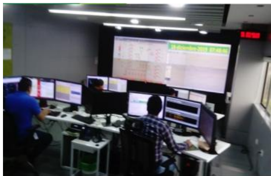
Figura 22. Centro de Control CENS
