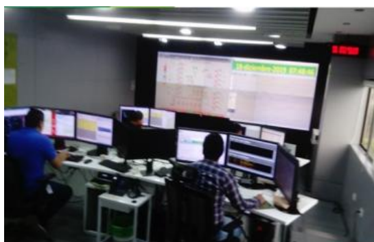
Figura 21. Centro de Control CENS
