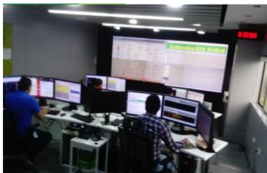
Figura 21. Centro de Control CENS
