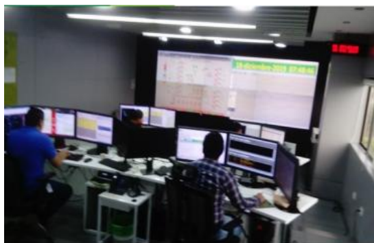
Figura 21. Centro de Control CENS
