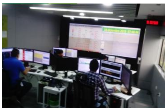
Figura 21. Centro de Control CENS
