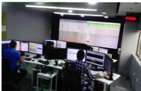
Figura 21. Centro de Control CENS
