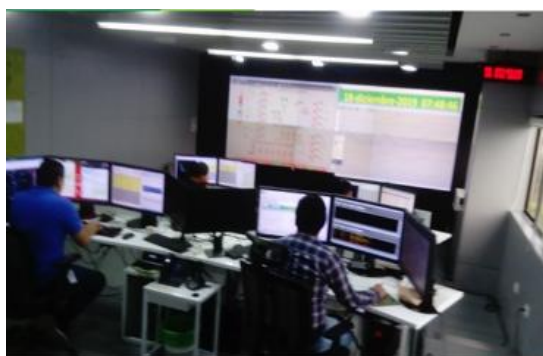
Figura 21. Centro de Control CENS
