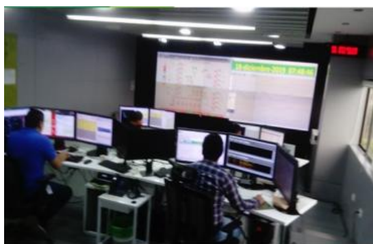
Figura 21. Centro de Control CENS
