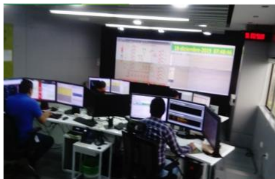
Figura 21. Centro de Control CENS
