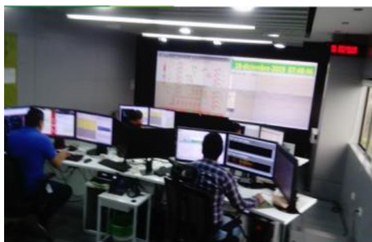
Figura 22. Centro de Control CENS
