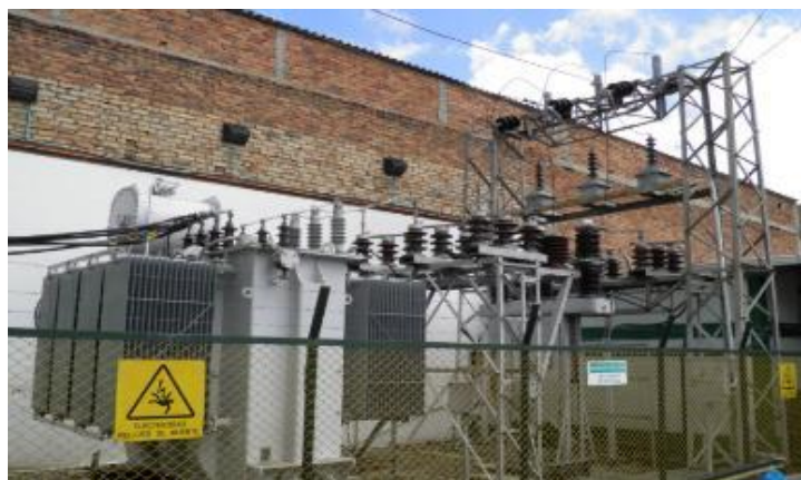
Figura 5. Fotos de la subestación
