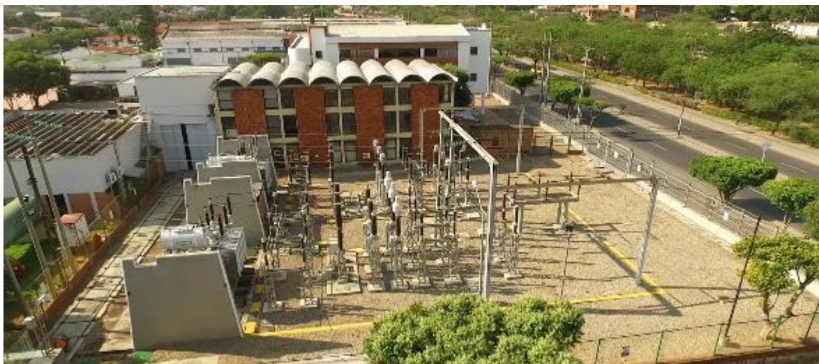
Figura 9. Fotos de la subestación
