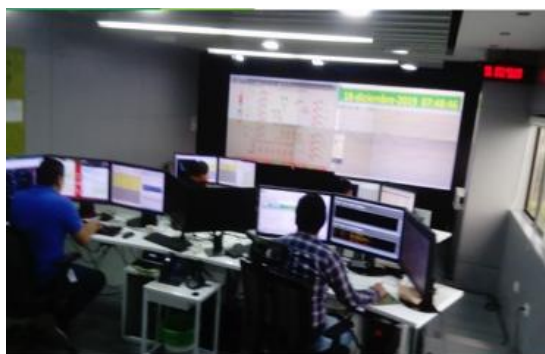
Figura 29. Centro de Control CENS
